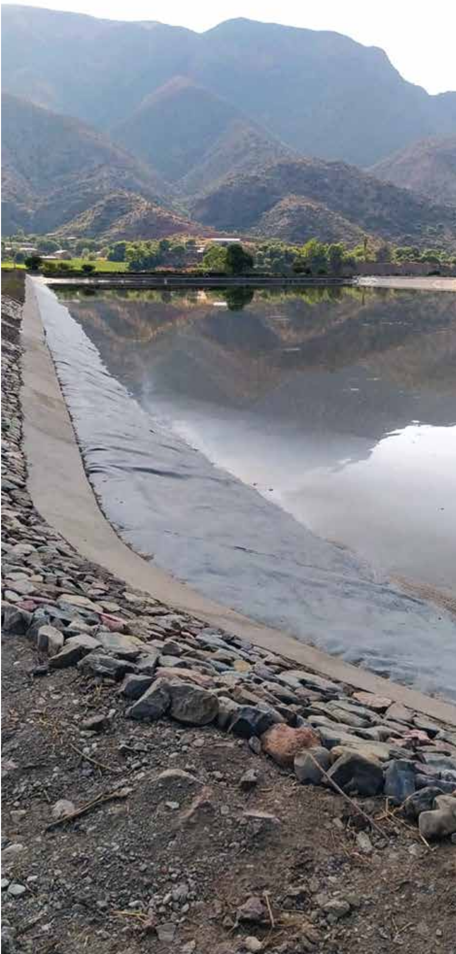
Una de las acciones de fortalecimiento del proyecto GAM fue la instalación de nueva geomembrana en la laguna facultativa N° 2 de la PTAR de Tupiza.
